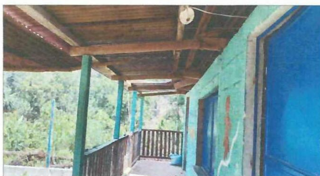
Foto 4: Se reemplazará las barandas de madera por celocillas nuevas.
