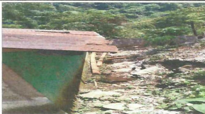
Foto 2: Se realizará limpieza de pared para reducir la humedad y reemplazar los blocks deteriorados
